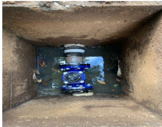
Figura 1- Hidrômetro analógico 100mm marca Hidrometer
