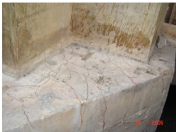
Figura 1 - Bloco de fundações com fissuras em forma de mapa
