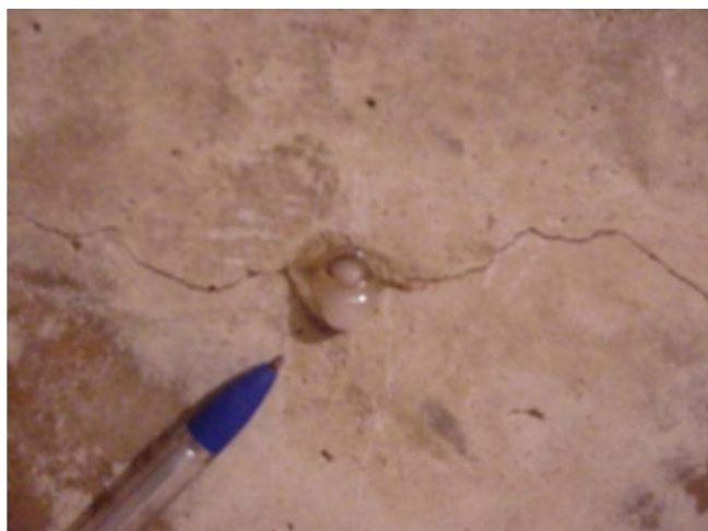
Figura 2- Detalhe de gel exsudando na superfície do concreto
