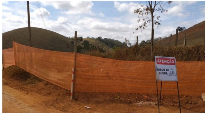
Figura 3 - Barreira de terra com sinalização de caixa
