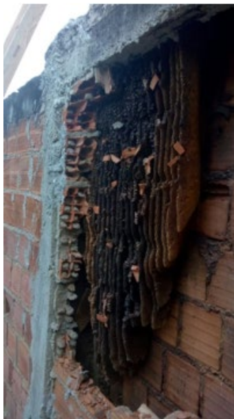
Figura 4 - Colmeia interna dentro da parede entre muro.
