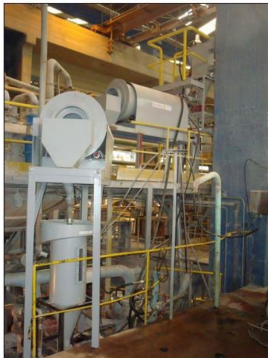
Figura 3 - Vista geral dos equipamentos crossflow, condicionadores e hydrofloat
