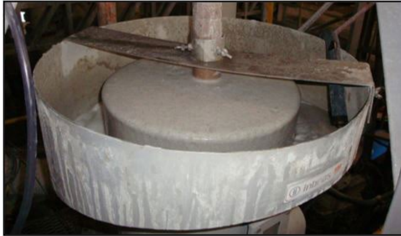
Figura 5 - Detalhe do transbordo de concentrado do Hydrofloat (overflow)
