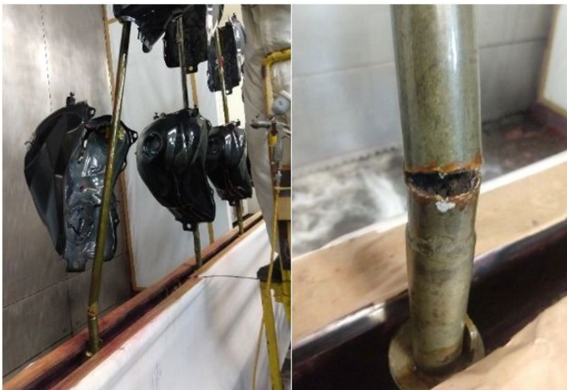
Figura 3 - Vara de sustentação de tanques com presença de fratura frágil.
