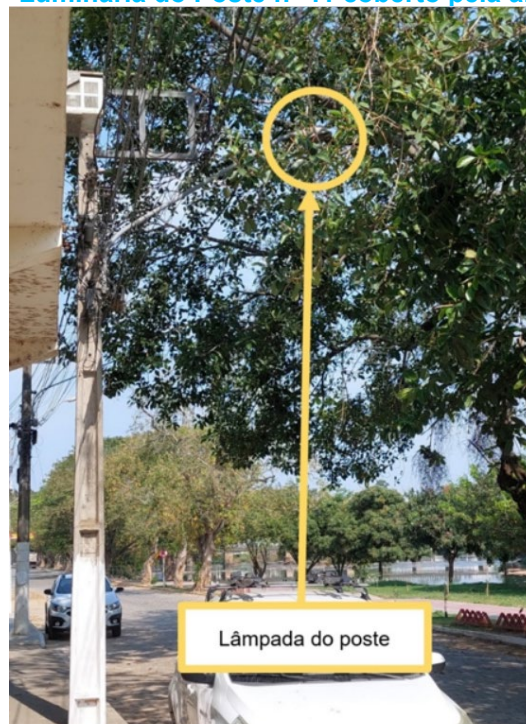
Figura 6 – Luminária do Poste nº 11 coberto pela arborização
