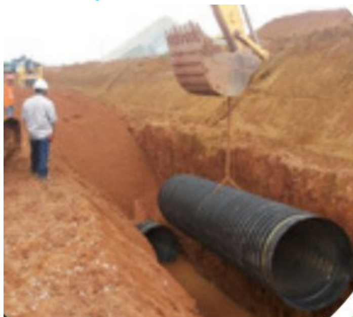
Figura 1 - Tubulação de PEAD.
