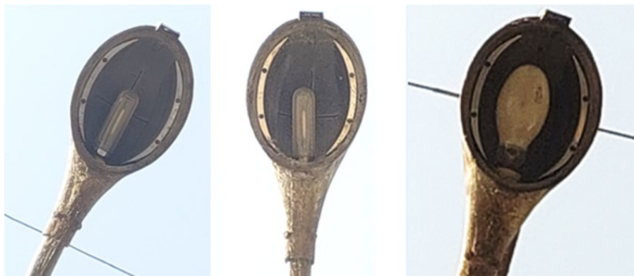
Figura 4 – Lâmpadas encontradas nos postes da Avenida Senador Francisco Tinoco
