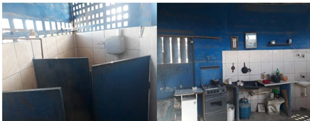
Figura 5 - Condições sanitárias e de conforto inadequadas
