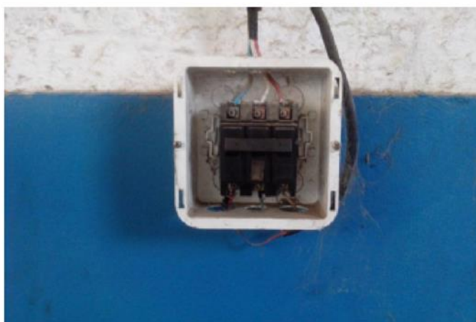
Figura 9 - Instalação elétrica sem proteção
