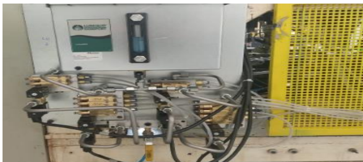
Figura 5 - Central de lubrificação
