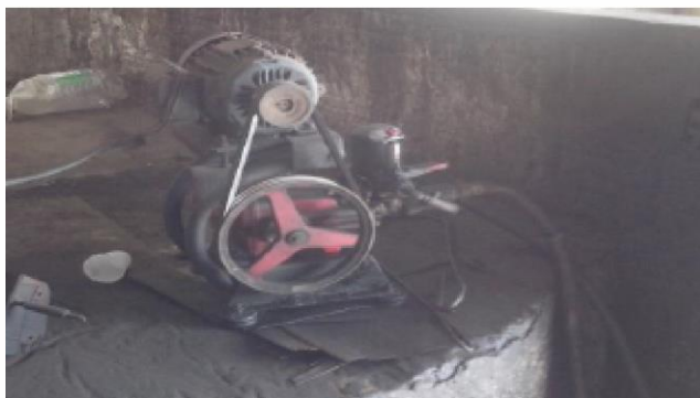
Figura 5 - Bomba sem proteção fixa
