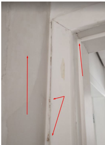
Foto 5 - Batente lado direito parte de dentro, presença de marcas de umidade, fungos, deterioração na madeira por umidade.
