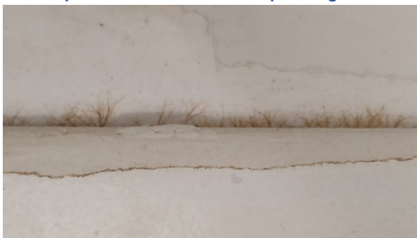
Foto 7 - Parte superior do batente tomada por fungos em ramificação.
