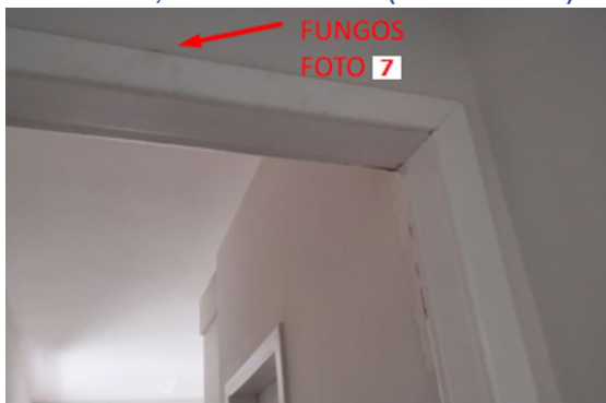
Foto 6 - Batente lado direito deteriorado pela presença de umidade constante, mancha de bolor (detalhe foto 7).
