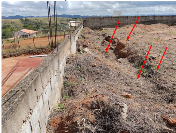
Foto 8 - Solapamento de solo no lote 3.
