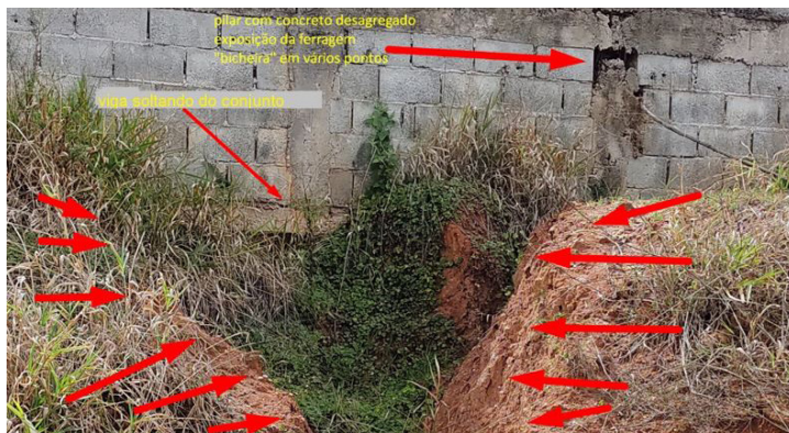
Foto 5 - Evidência de falha construtiva e acidente de solo.
