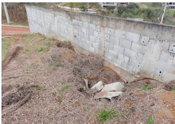
Foto 8A - Entulho e afundamento.
