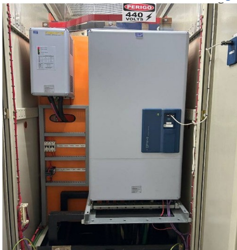
Figura 11 - Inversor Exaustor e modulo de Franagem WEG.
