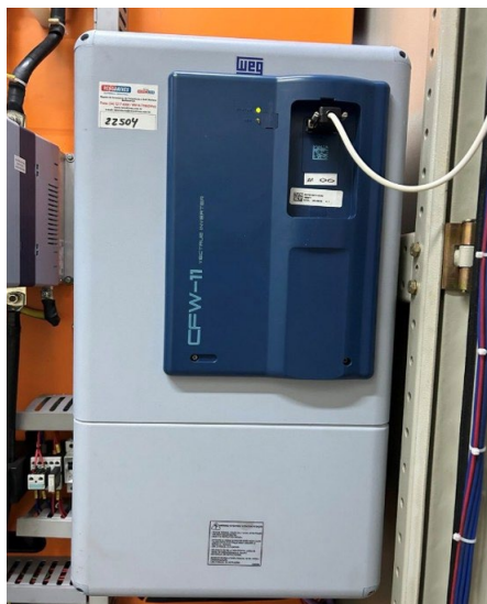
Figura 10 - Inversor Ventilador Primário WEG CFW011.
