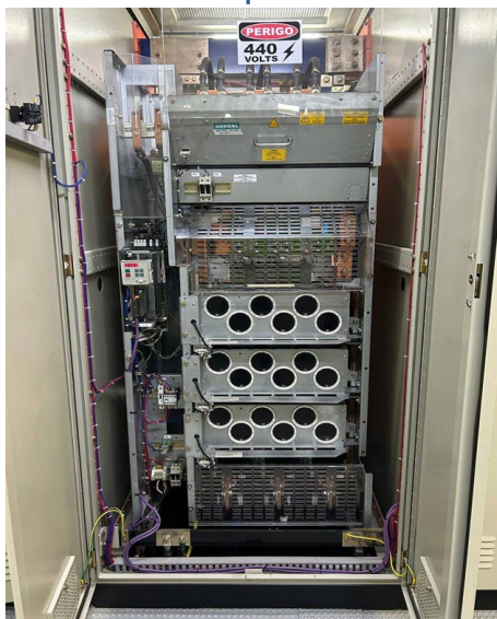
Figura 7 - Inversores de Frequência Simovert Exaustores.
