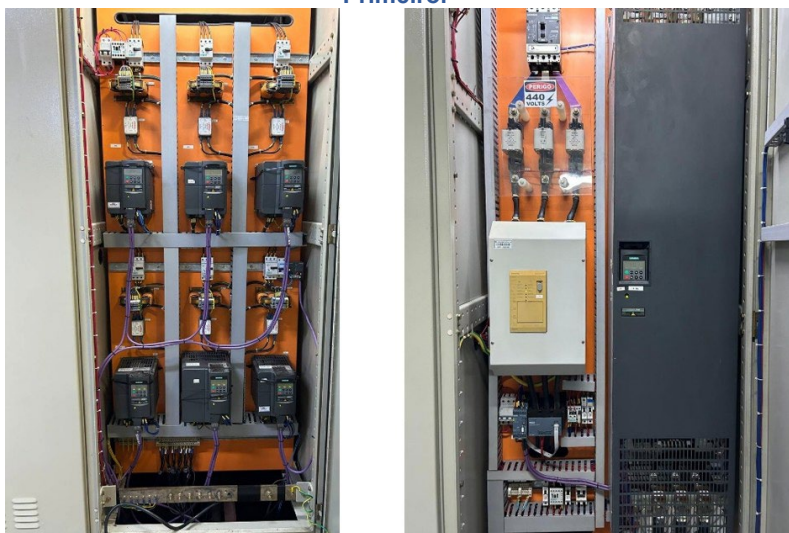
Figura 6 - Inversores Dosadores de Bagaço, Softstarter e Ventilador Primeiro.
