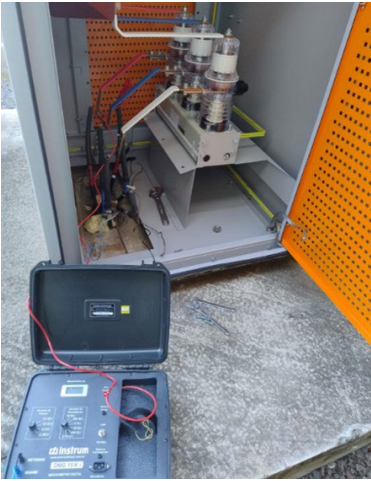
Imagem 5 - Ensaio com Megômetro nos Cabos de Saída.
