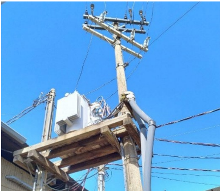
Imagem 7 – Transformador de 300kVA.
