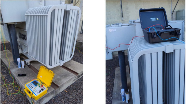
Imagem 4 – Ensaios com Megômetro e TTR no Transformador.
