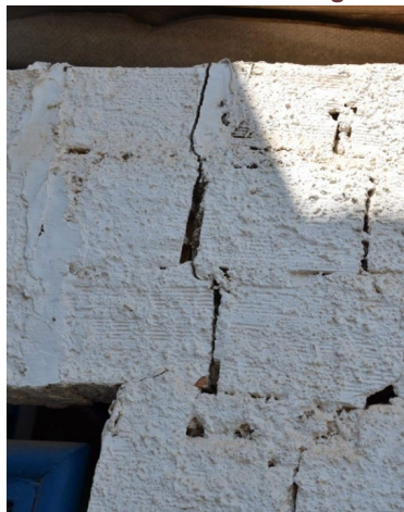
Figura 08 – Rachadura vertical de grande perigo.
