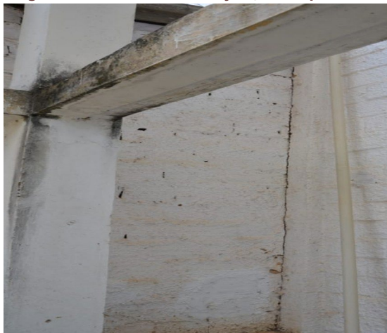
Figura 04 – rachaduras na junção de paredes.
