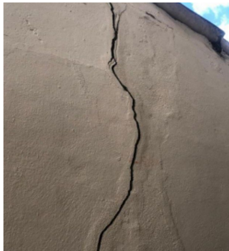
Figura 06 - Rachaduras em paredes.
