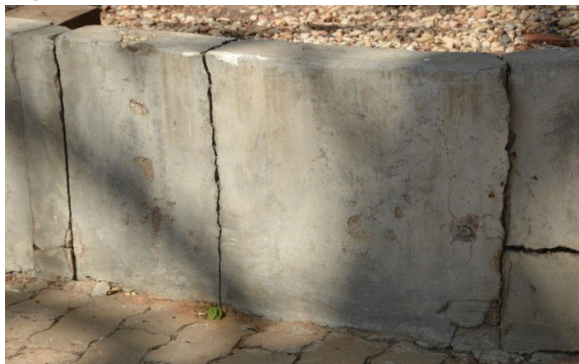
Figura 07 - Rachaduras em barreira de contenção.
