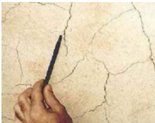
Figura 01 – Fissura em argamassa de revestimento.
