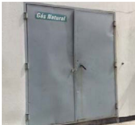
Figura 22 - Porta danificada da sala de condicionamento de gás natural.
