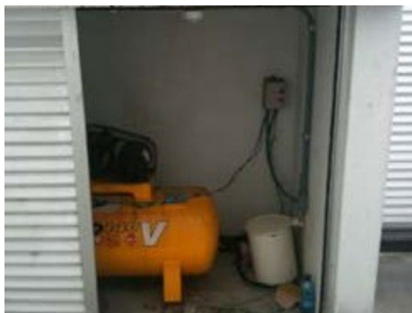
Figura 18 - Ausência da porta do compressor de ar.
