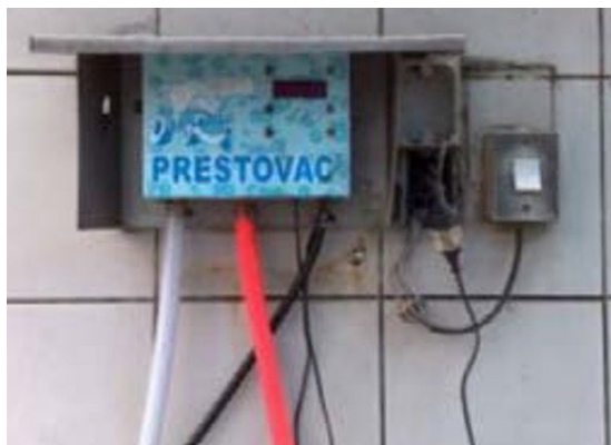
Figura 21 - Figura exporta do quadro de comando elétrico do equipamento de lavagem de veículos.
