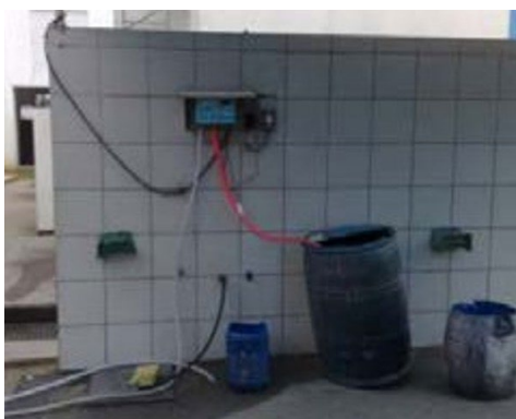
Figura 20 - Utilização de recipientes inadequados e sem rotulagem de identificação de produtos químicos.
