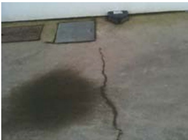
Figura 16 - Fissura no pavimento.
