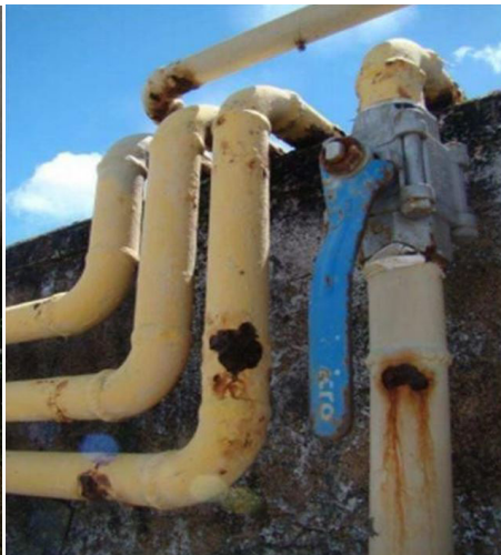
Figura 12 - Ferrugem em tubulação.
