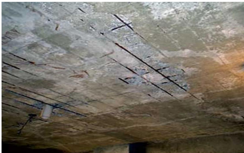
Figura 7 - Cobrimento das armaduras insuficiente.
