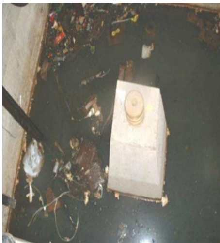
Figura 13 - Lixo no poço do elevador.
