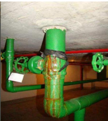
Figura 14 - Emenda imprópria e vazamento.
