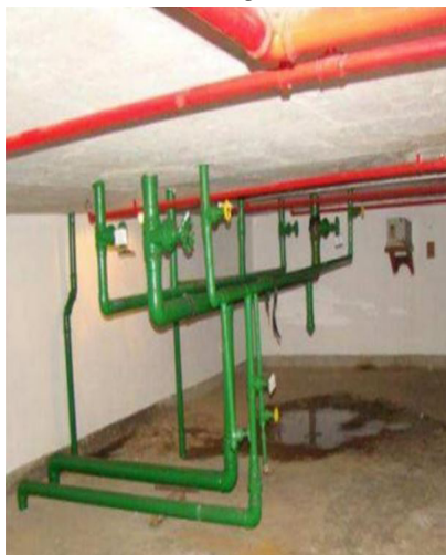
Figura 15 - Vazamento na tubulação.
