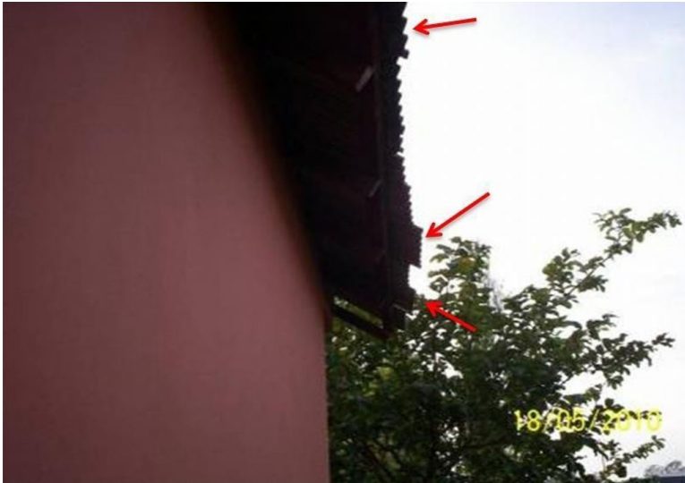
Figura 8 - Deslocamento de telhas causado por obra vizinha (bate estaca).
