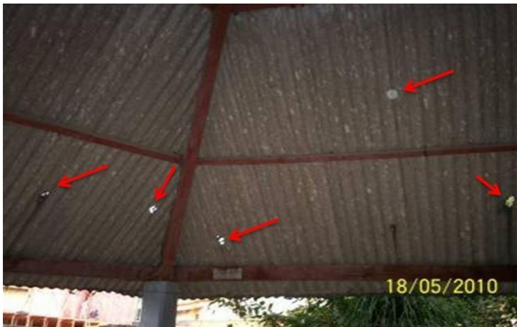
Figura 10 - Furo nas telas por chuva de granizo.
