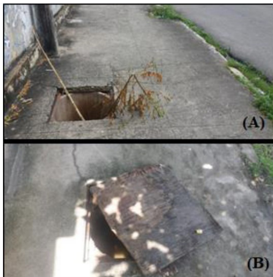
Figura 47 - Avenida Filomeno Gomes - Tapa de Esgoto Aberta.
