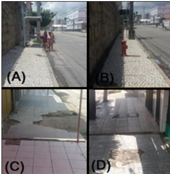
Figura 48 - Avenida Filomeno Gomes - Problemas Trecho 2.
