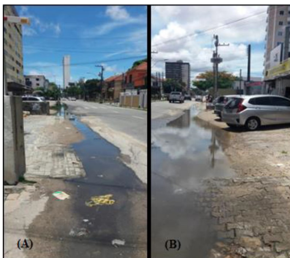
Figura 30 - Avenida Francisco Sá - Ausência de Drenagem.
