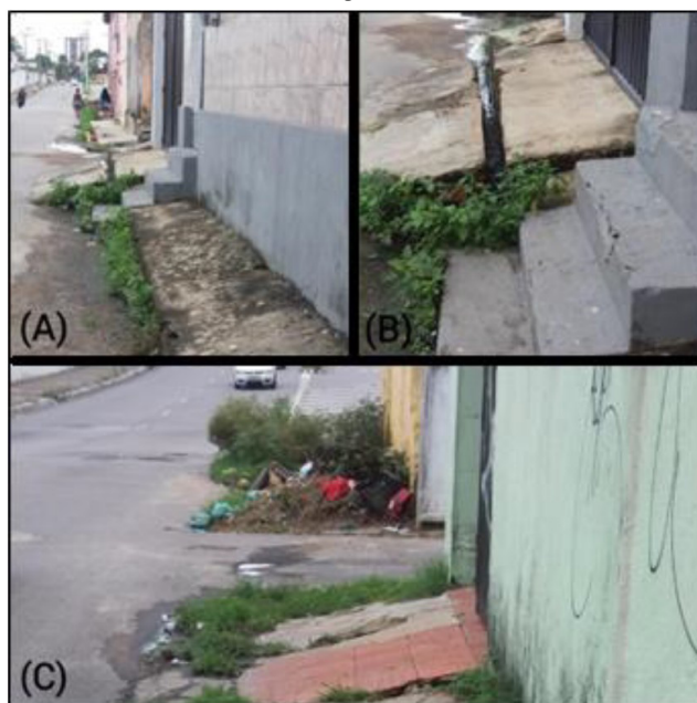
Figura 39 - José Jatahy/ Adriano Martins - Obstrução de Calçada.
