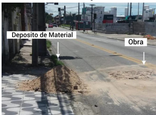
Figura 36 - Avenida Francisco Sá - Depósito de material sobre a Calçada.
