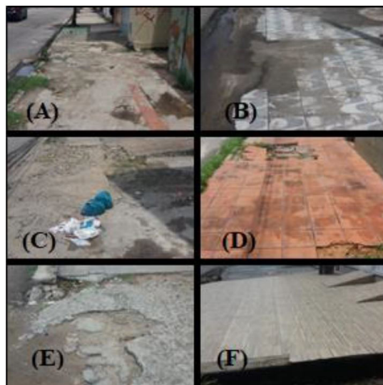
Figura 22 - Av. Presidente Castelo Branco - Piso Inadequado.
