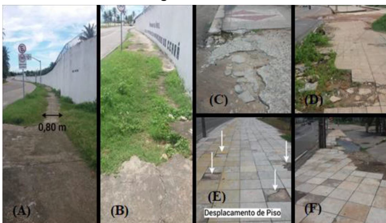
Figura 23 - Av. Presidente Castelo Branco - Problemas no Segundo Trecho.
