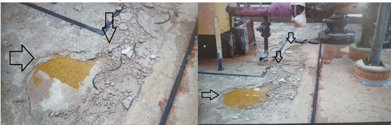
Figura 3– Delaminação do concreto armado.
