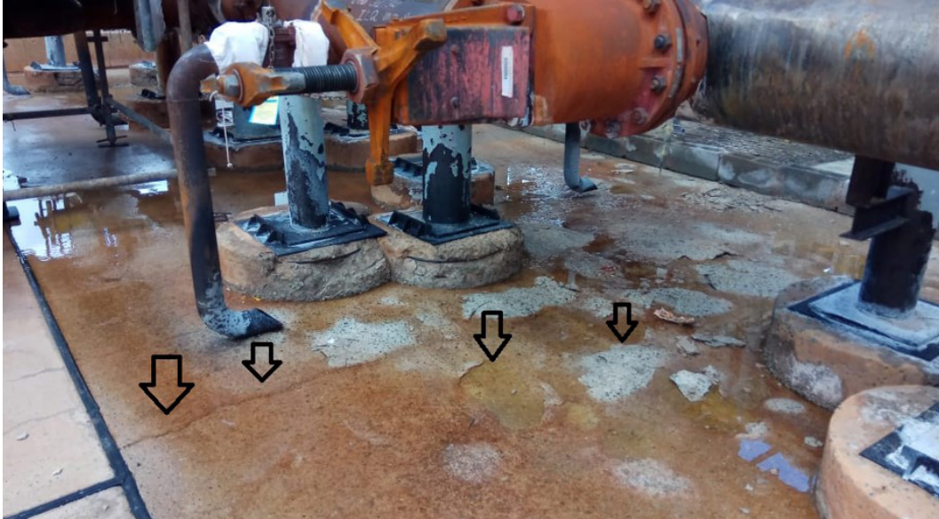
Figura 4 – Degradação do concreto e fissuras mapeadas.
