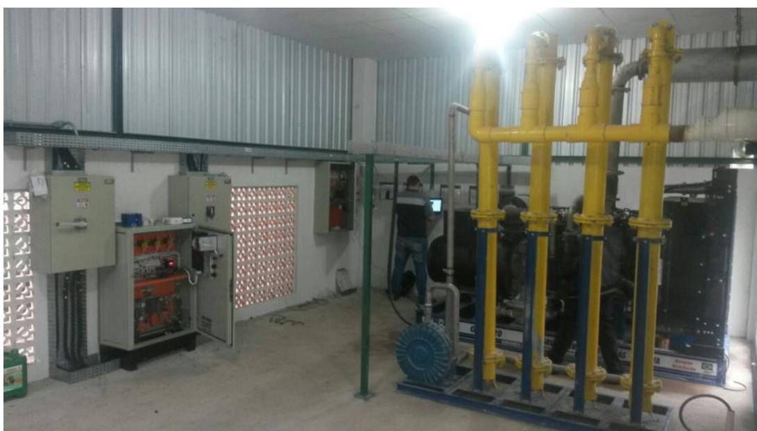
Figura 4 - Gerador Biogás na Amidos Pasquini.
