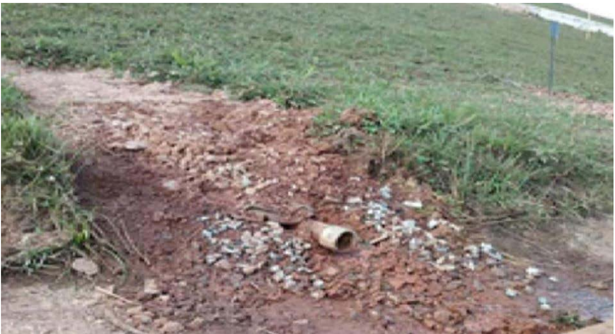
Figura 17 - Surgência de água no entorno da saída de Dreno Horizontal Profundo.
