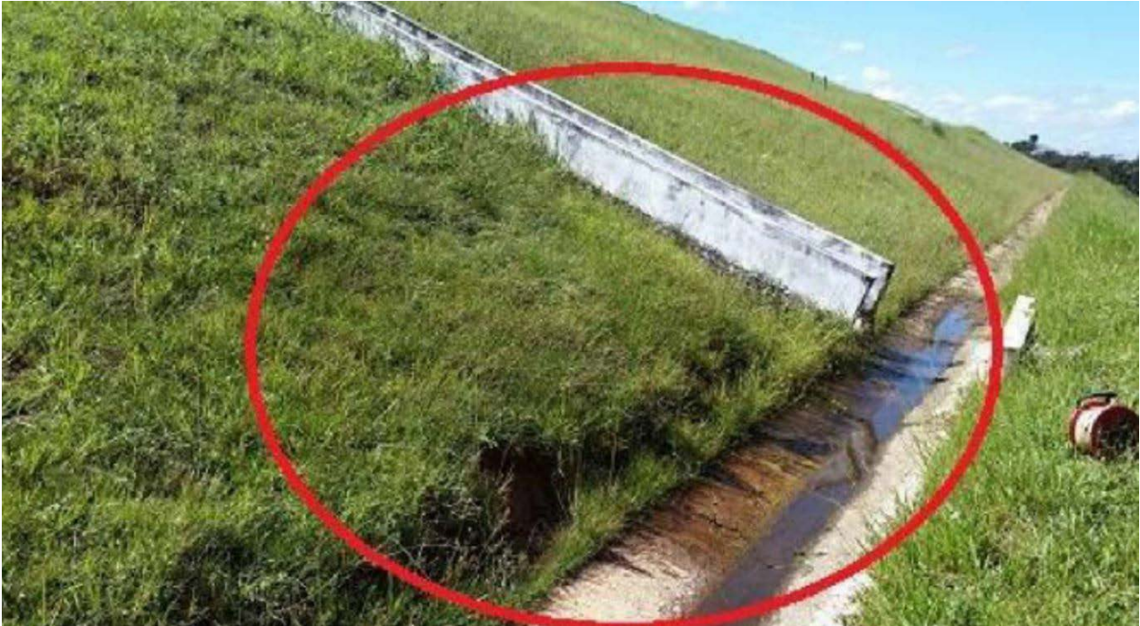
Figura 18 - Surgência de água no talude próximo à canaleta de drenagem, que está assoreada.
