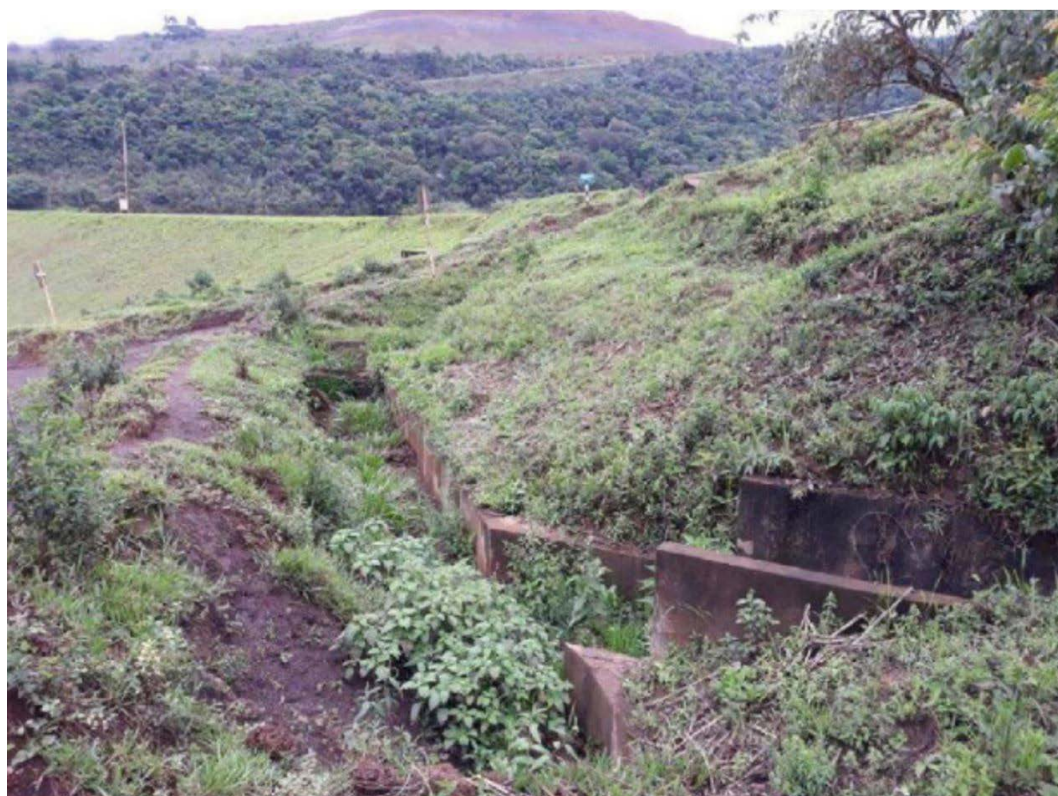
Figura 15 - Vegetação arbustiva no talude do barramento e dentro das canaletas de drenagem.
