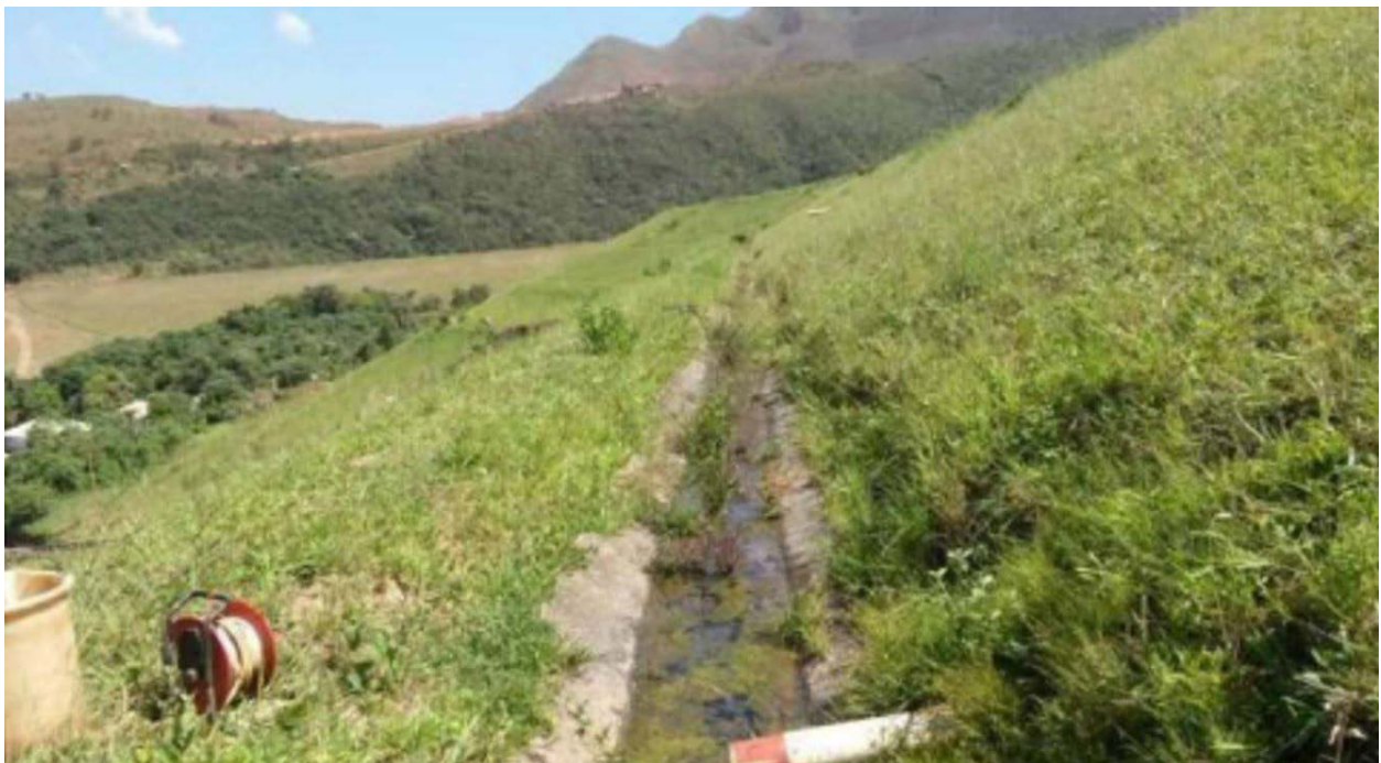
Figura 19 - Canaleta de drenagem constantemente assoreada e acumulando água
