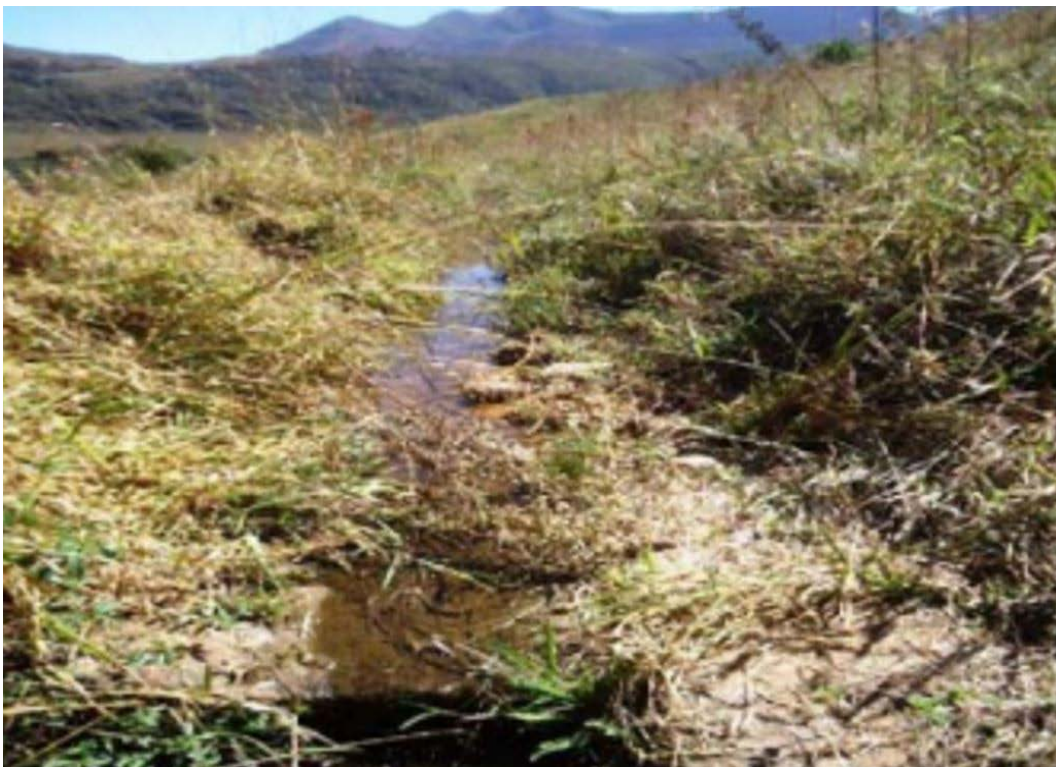
Figura 11 - Vegetação alta obstruindo a canaleta de drenagem.
