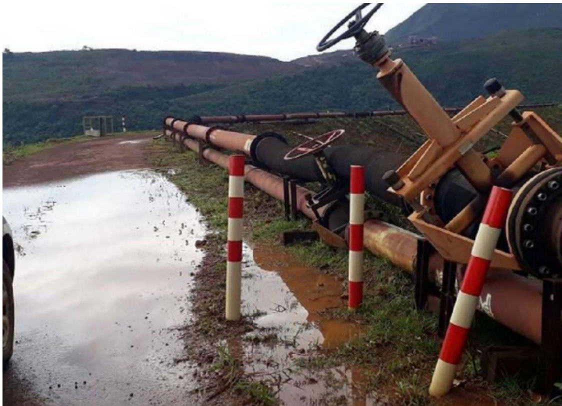
Figura 21 - Drenagem superficial da barragem obstruída com acúmulo de água na crista do barramento
