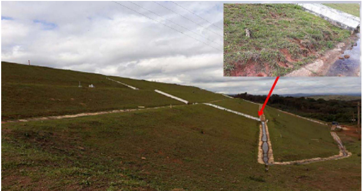
Figura 16 - Surgência de água no talude junto à canaleta.
