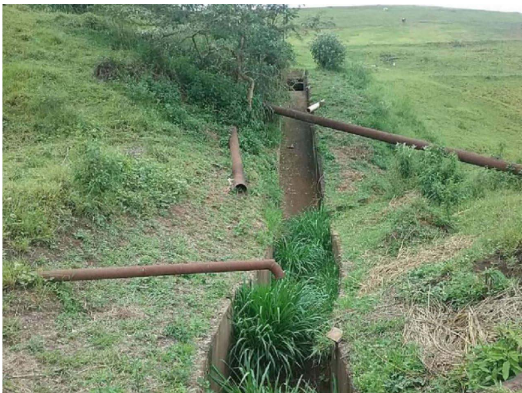
Figura 14 - Obstrução de canaleta por vegetação.
