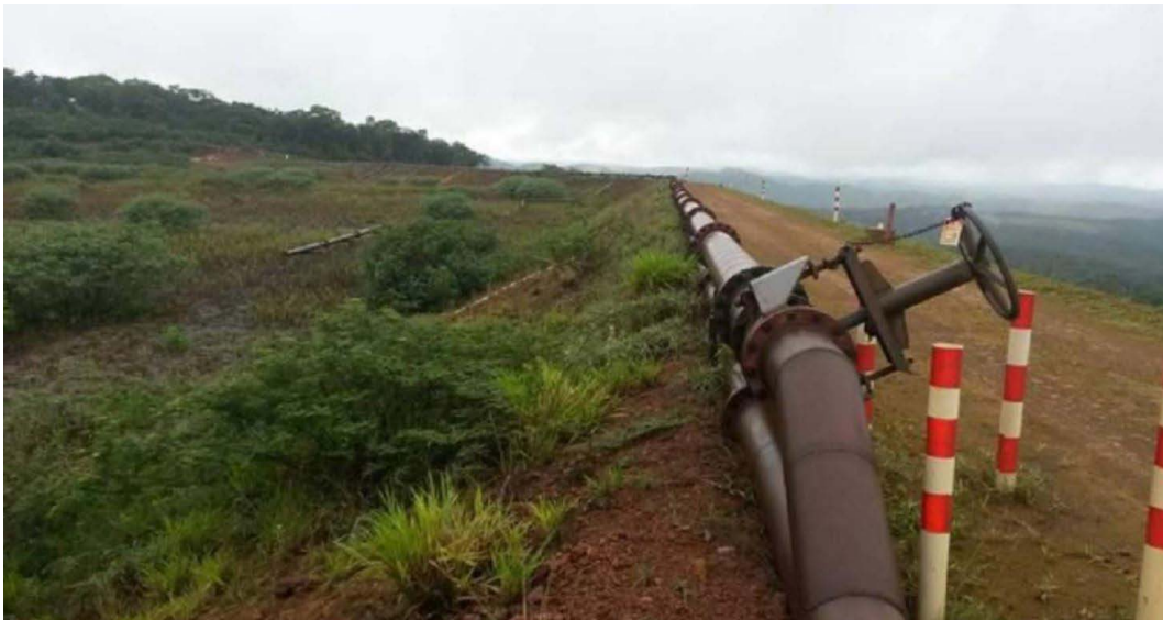
Figura 13 - Vegetação arbustiva no talude de montante e dentro do reservatório.
