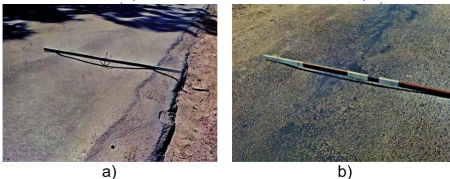
Figura 1 - Afundamento: a) afundamento de trilha de roda; e b) afundamento local
