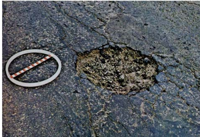
Figura 6 - Panela ou buraco.
