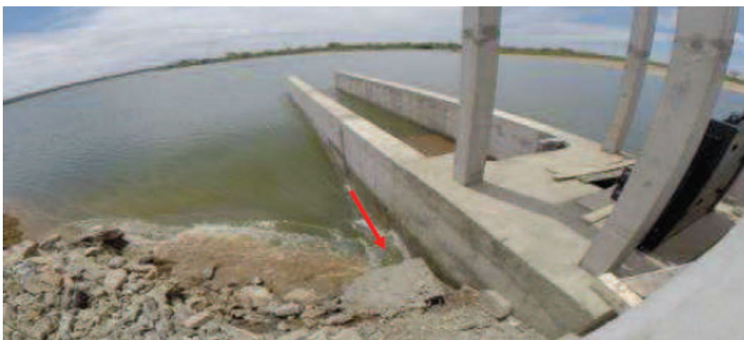
Foto 4 - Vista de montante mostrando a infiltração de água junto à parede de concreto do muro lateral direito do canal de aproximação da tomada d'água. (03/03/2017).
