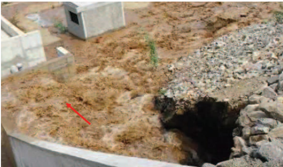
Foto 3 - Vazamentos de água de forma espreada, por cima da laje da galeria. (03/03/2017).
