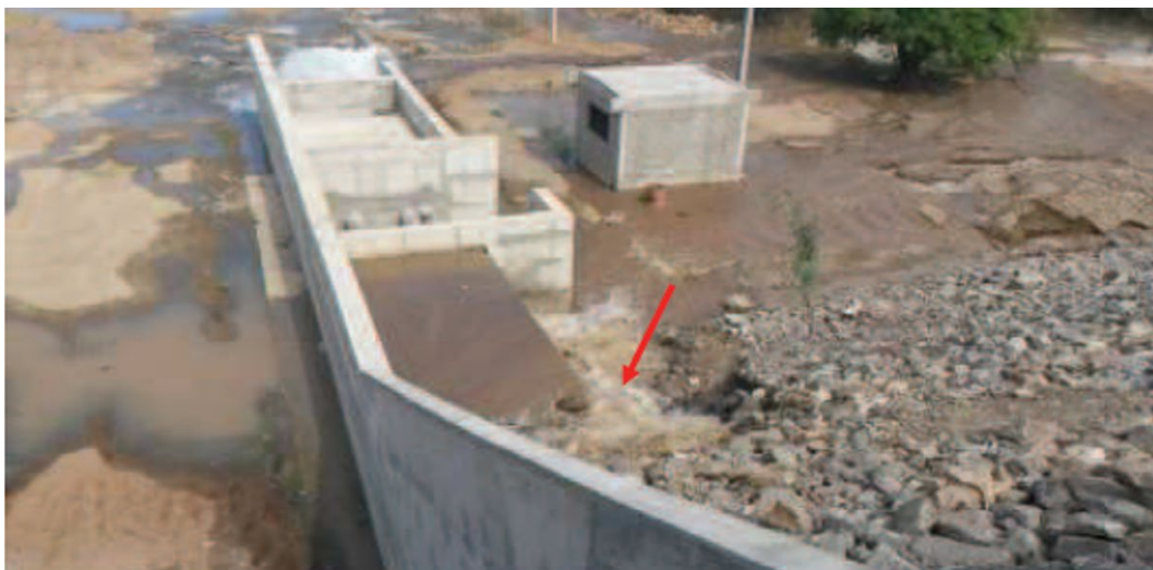
Foto 2 - Vazamento inicial detectado às 7:00 h de 03/03/2017, no talude de jusante da barragem junto a laje da galeria de uso difuso, no entorno da cota 536,28 m, que coincide com a cota do dreno sanduiche de areia + pedrisco + areia. (03/03/2017).
