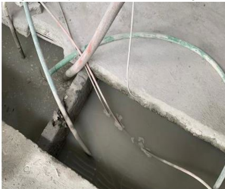
Figura 6 - Tanque de decantação coberto. Estágio 01.
