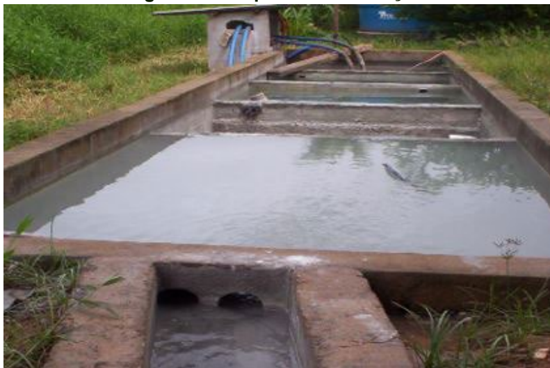
Figura 5 - Tanques de decantação.
