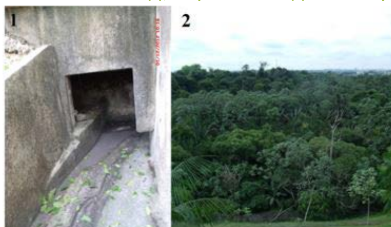
Figura 2 – Emissão de efluente do S2 (1), Parque Sumaúma (2) onde é despejado o efluente.
