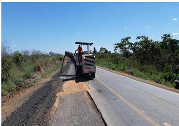
Figura 7 - Fresagem contínua com adição de material para regularização de degrau pista e acostamento BR 364/RO.
