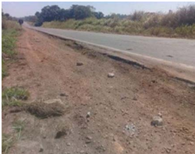
Figura 6 - Degrau acentuado Rodovia BR 364 - Estaca 590
