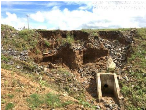
Foto 33 - Compactação de material para tratamento de erosão do maciço da estrada de O&M, no lado direito hidráulico do canal, na altura da estaca E-7844 do segmento de canal WBS 2220.
