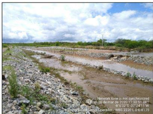
Foto 7 - Ponto de transbordamento das águas do Rio Moxotó para o interior do canal do PISF no lado direito hidráulico, na altura da estaca E-8135 do segmento de canal 2221.
