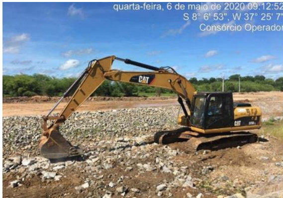
Foto 33 - Atividade de recuperação do talude enrocado do canal no L.E hidráulico, na altura da estaca E-8135 do segmento de canal WBS 2221.
