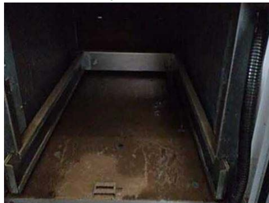
Foto 12 - Condição inicial dentro dos cubículos disjuntores, especificamente os contatos fim de curso e marca até onde a água atingiu
