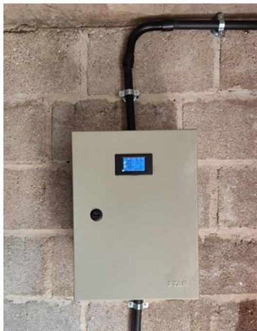
Figura 9 - Painel de Medição e Proteção
