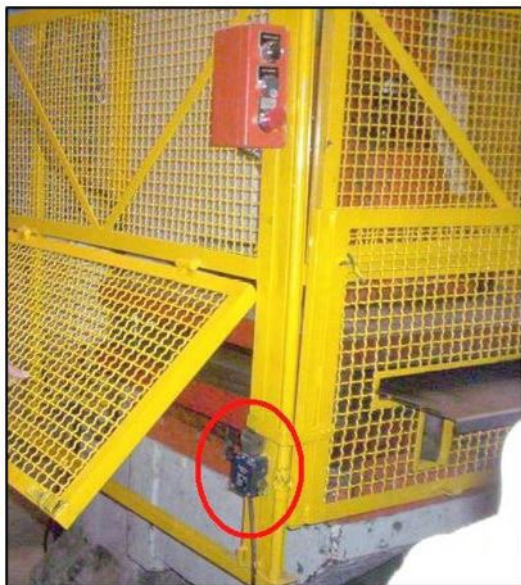
Figura 5 - Enclausuramento da zona de prensagem por proteções móveis intertravadas.
